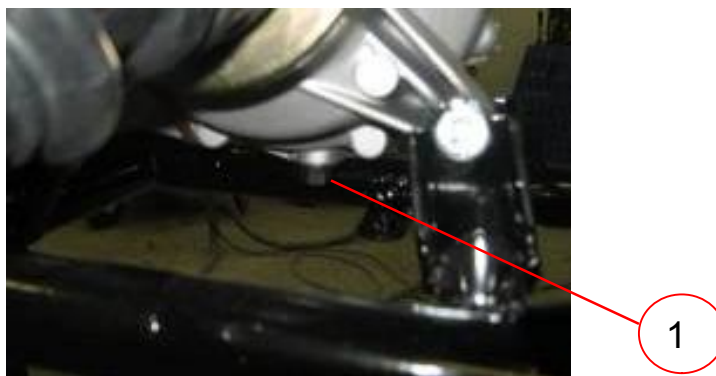
1 – пробка сливного отверстия
